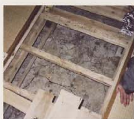
床下に発生したカビ
