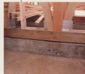
コンクリートの打設不良
