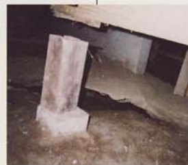
地盤沈下による束の沈み
