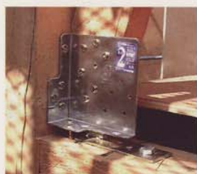
金物の施工不良
