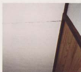
内装下地(石コウボード)の亀裂
