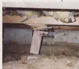
地盤沈下に伴う不適切な補修
