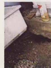
地盤沈下による陥没
